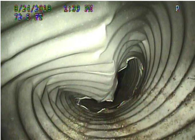
손상된 주름 금속관 내부의 CCTV 이미지.
